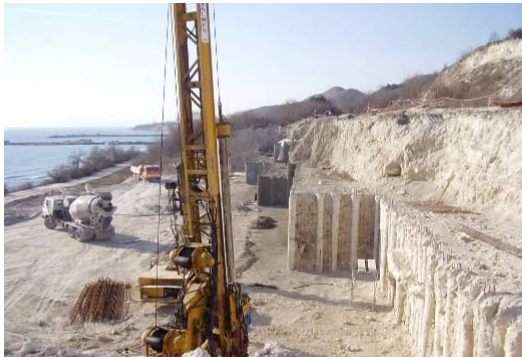
Утврдување на ископувањето на јамата "СПА станбен комплекс" Бели брег "во ЈУ, Топола селски регион, Општина Каварна, Добрич област
